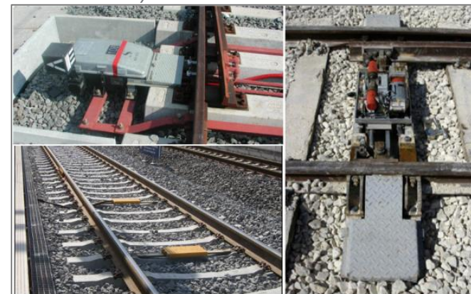
Figur 2.5. Elektrohydrauliske sporskiftedrev fra henholdsvis Thales & Strukton og Alstom samt en passiv ETCS balise (nederst TV), som også anvendes på S-banens CBTC-system.
