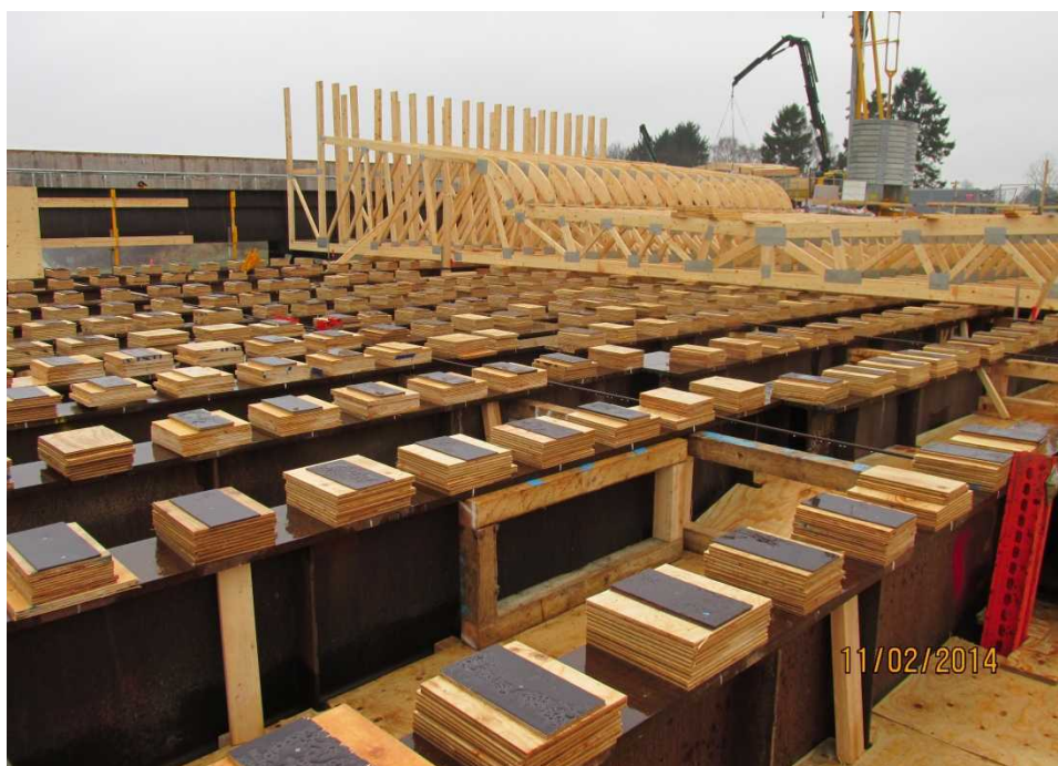
Figur 46. Foto fra montagen af træspær. Opklodsninger for træspær er udlagt foran de allerede monterede spær på de langsgående stålbjælker.
