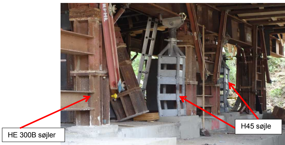
Figur 31 Lejelinje ved girder 2 set fra nord. Bemærk deformationerne i H45 søjlerne.
