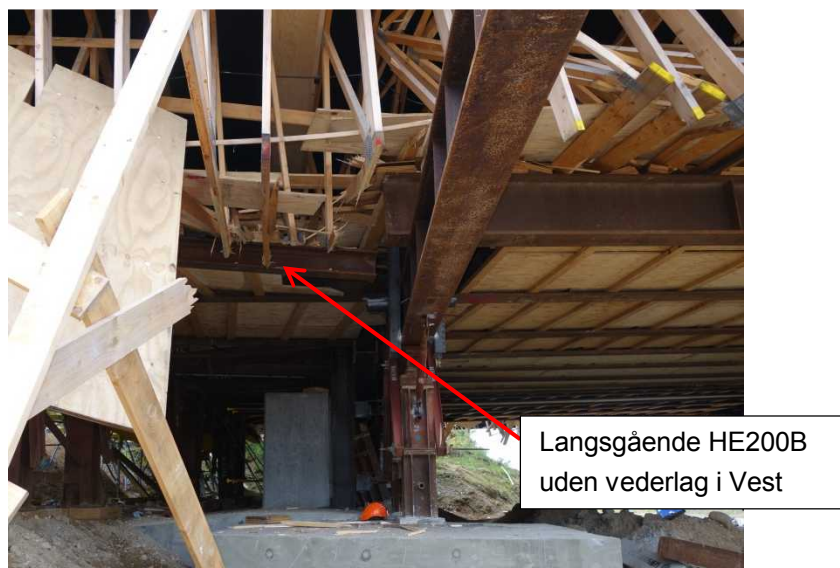
Figur 28 Foto fra nord ved girder 2.
