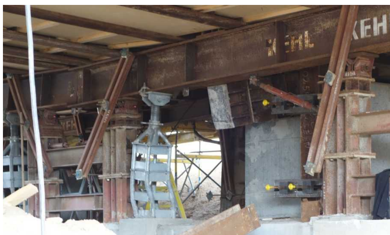
Figur 32 Lejelinje ved girder 2 set fra Syd. Svært deformerede H45 søjler, der er knækket ud som følge af overbelastning
