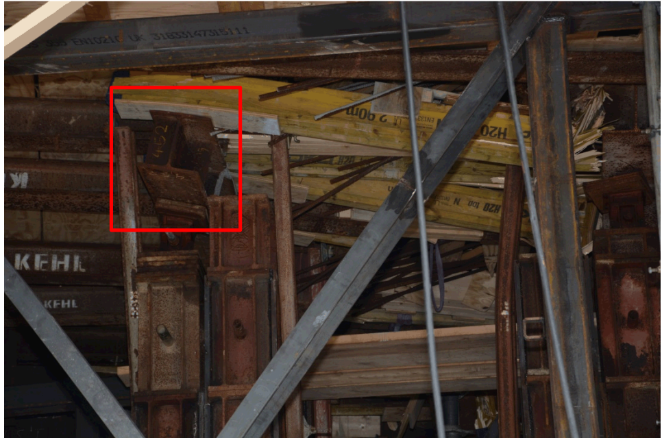
Figur 30. Tværdrager med begyndende kæntring.
