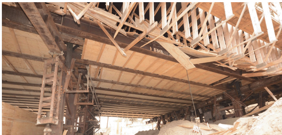
Figur 14. Brud i spærkonstruktionen mellem girder 2 og 3 set fra syd
