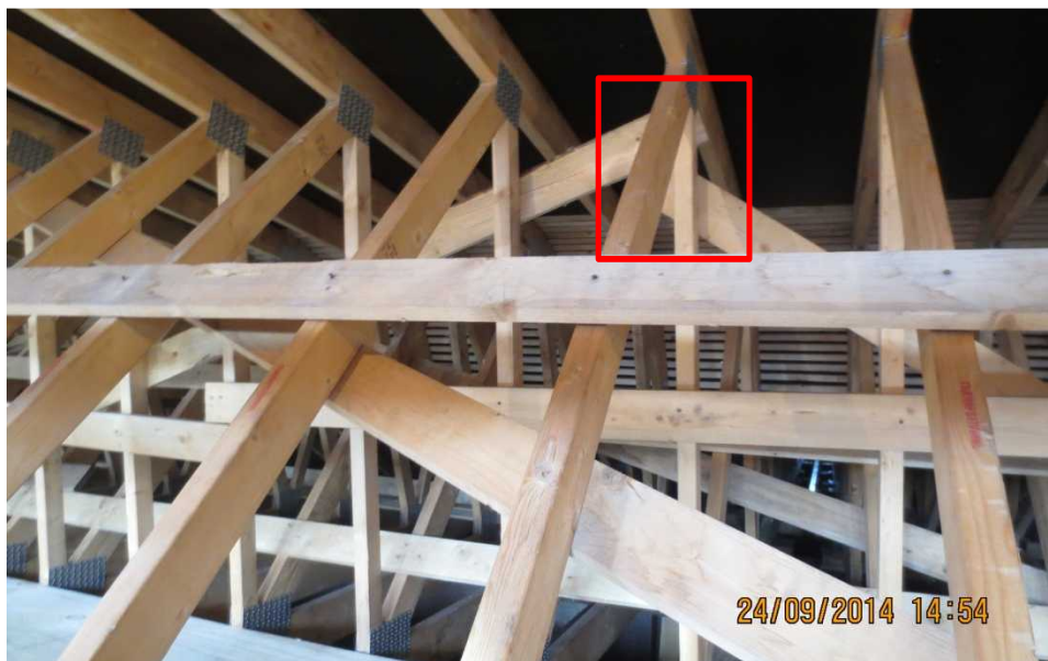
Figur 41. Som foregående foto, bemærk også afslutning for oven af skrålægte rammet ind med rødt.
