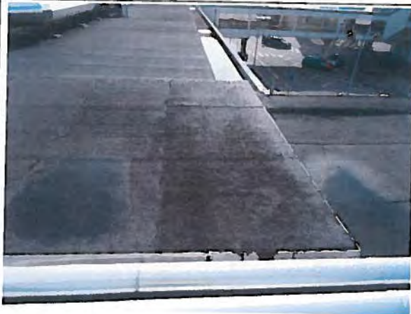
Foto 3: Opbygget tag er nedslidt.
