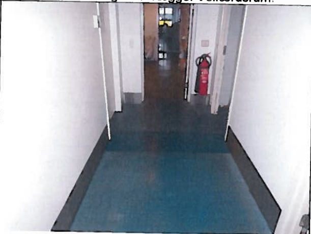
Foto 29: Hævet terrændæk. Gang v. printerrum.
