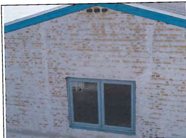
Foto 7: Revne i gavl og tegloverligger.
