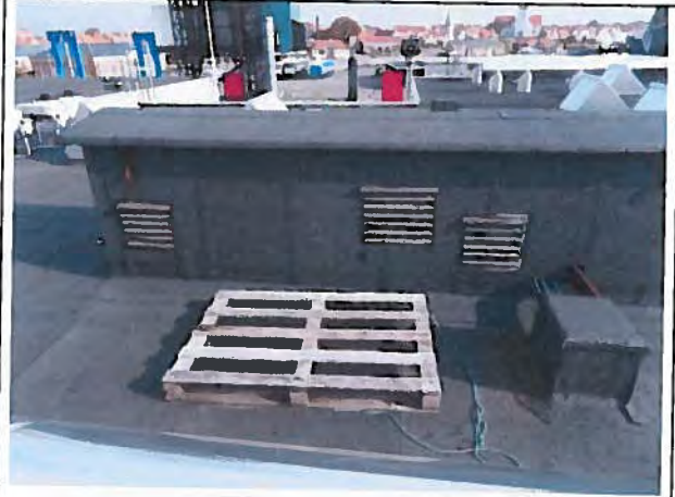
Foto 4: Ventilatorhus, nedslidt pap
