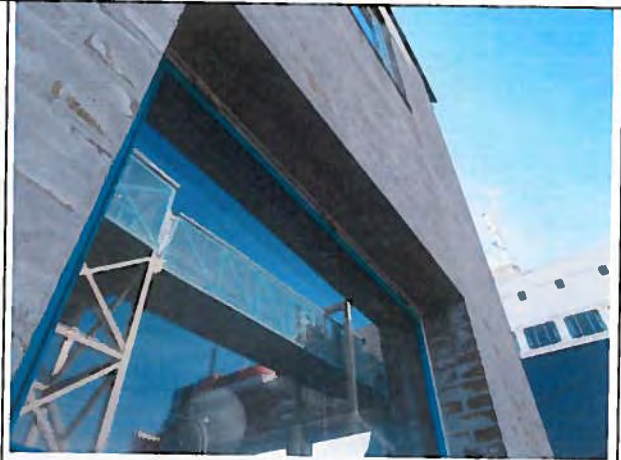
Foto 16: Revnet murværk, alle teglbjælker i gavl.
