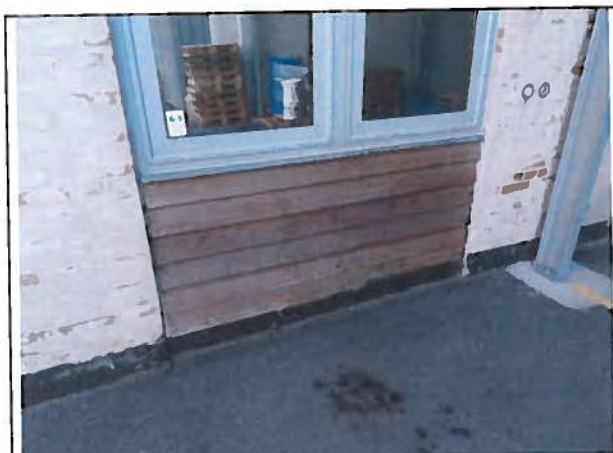
Foto 19: Defekt træbeklædning, mgl. vedligehold.
