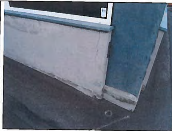
Foto 13: Revnet facade. Afskallet sokkel.
