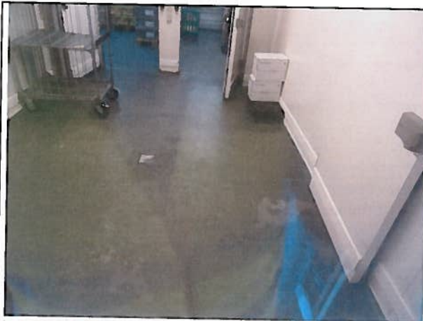
Foto 25: Afskallet epoxygulv ved kølerum
