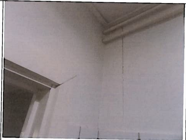
Foto 28: Revner i gulv & vægge. Velfærdsrum.
