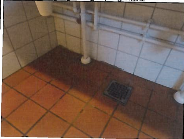
Foto 27: Tæret rør, revnede fliser & klinker.
