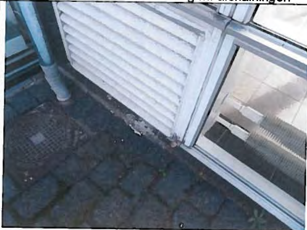
Foto 15: Nedbrydning i karme, vindfang.
