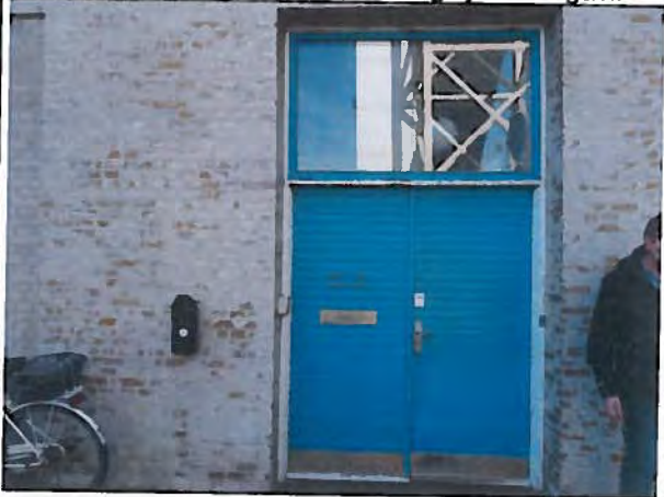
Foto 17: Forvitret tyndpuds. Nedbrudt trædør.
