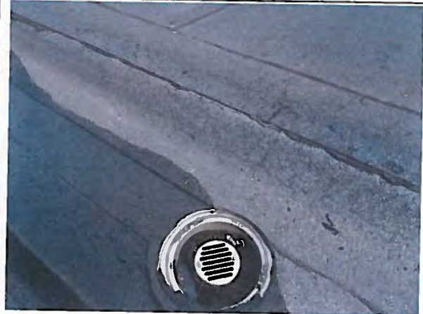
Foto 5: Tagpap med revner/krakelering
