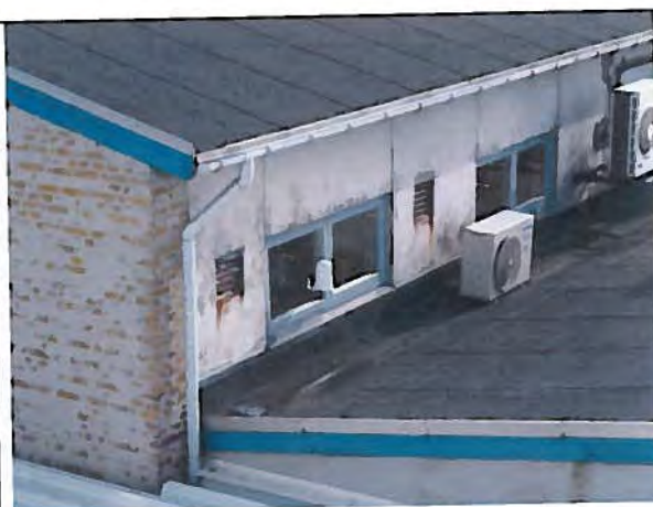
Foto 10: Begroet facade, rustne riste
